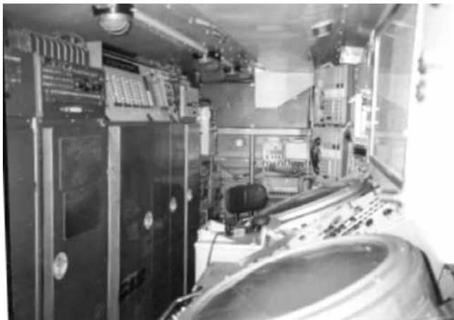
Fot. 8.3. System „Wozduch-1M” obiekt WP-01M
