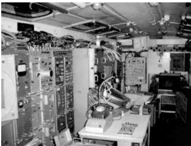
Fot. 8.1. System „Wozduch-1p” obiekt 2B
