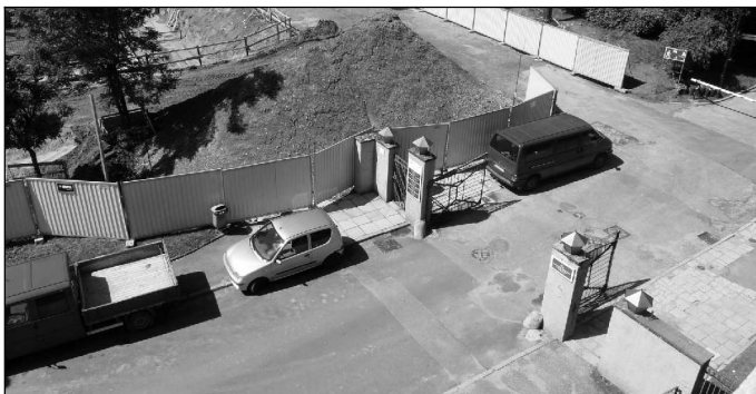
Budowa krytej pływalni wraz z zapleczem dydaktycznym – stan na czerwiec 2011 r. (przy bramie nie ma już budynek w którym, w różnych okresach, mieściła się wartownia lub poczta i zakład fryzjerski).
